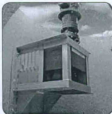
Mini Monster инсталиран в помпна станция
