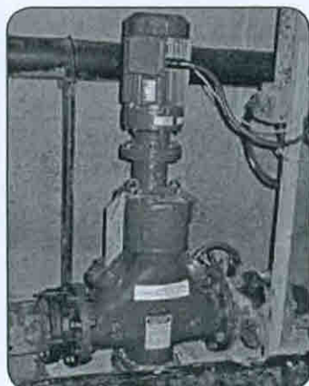
При тръбопровод Muffin Monster
